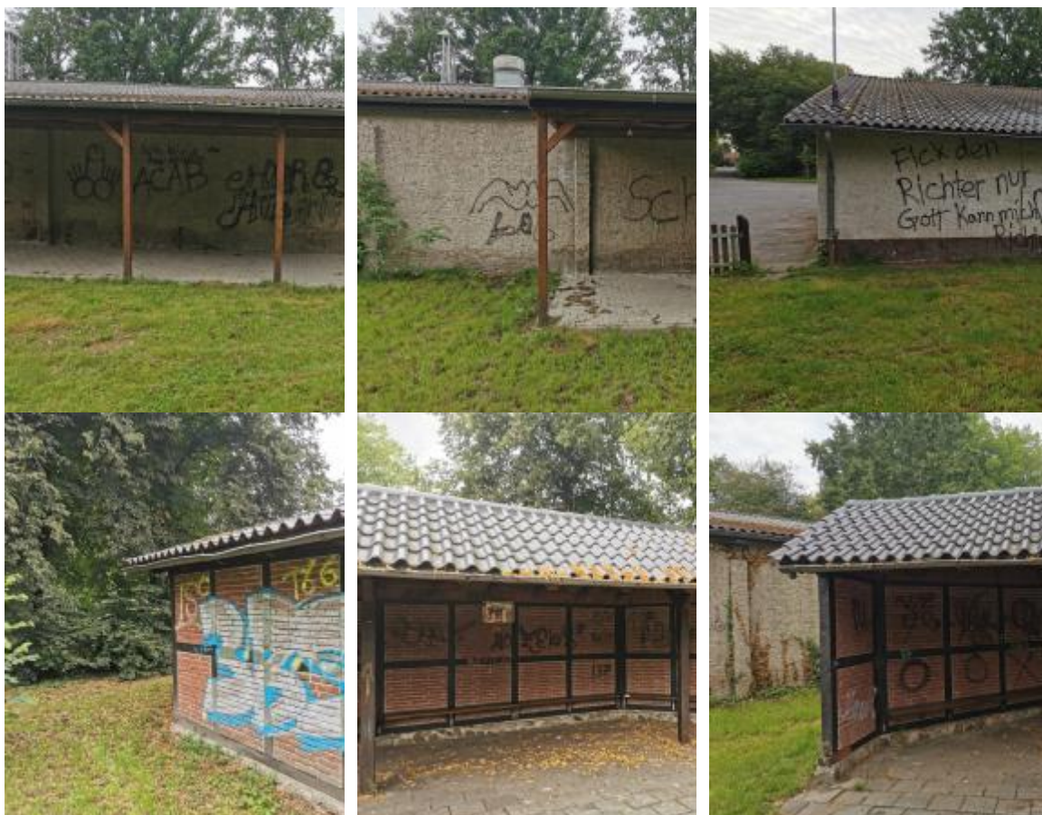
Am Schützenhaus und am Grillplatz haben Unbekannte mit Sprühdosen Schmierereien hinterlassen. Auch am Unterstand haben die Unbekannten auf dem Fachwerk ihre Zeichen aufgesprüht.
